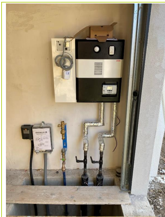
Abbildung 12: HÜS ist montiert und primärseitig angeschlossen
